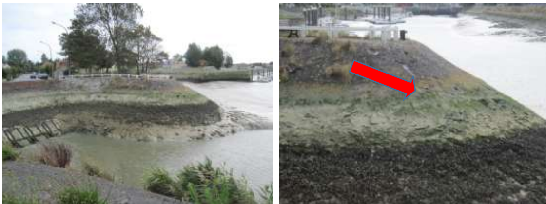
Vues du principal point de débordement vers Petit-Fort-Philippe dans le chenal de l'Aa où on distingue nettement la hauteur d'eau à marée haute (flèche)
